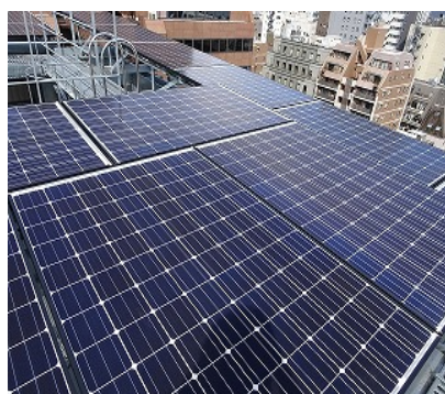
太陽光発電パネル（屋根面）
