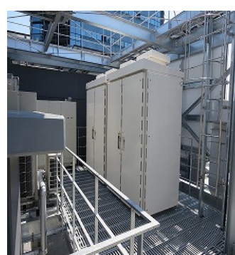
蓄電システム
