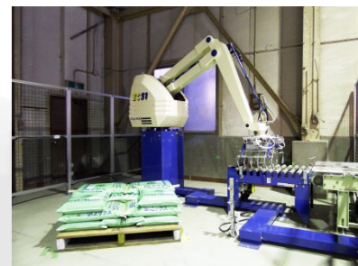
横浜合材工場 (常温合材自動袋詰機)
