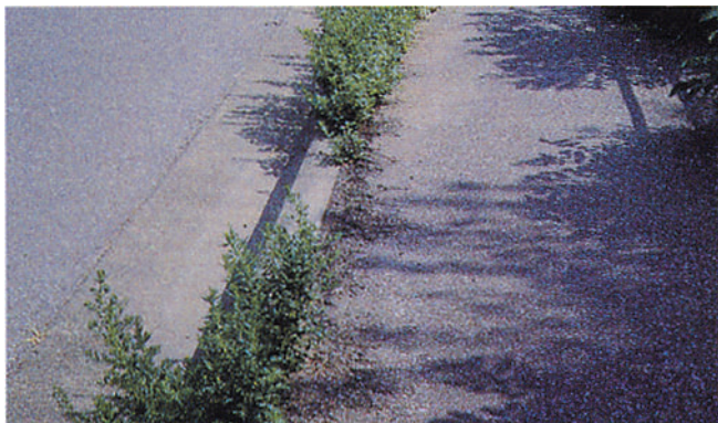
構造物との間に繁茂した雑草
