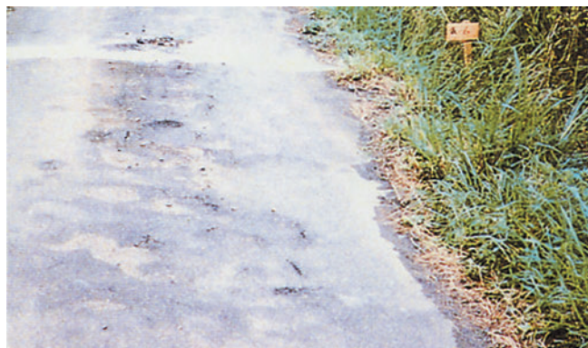
木の根による盛り上がりやアスファルト舗装を貫通した雑草
